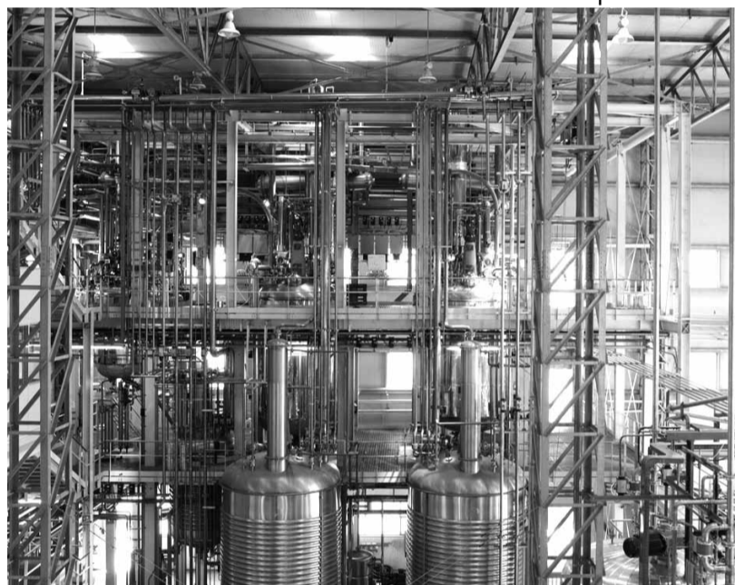
La parte dello stabilimento preposta alle resine
